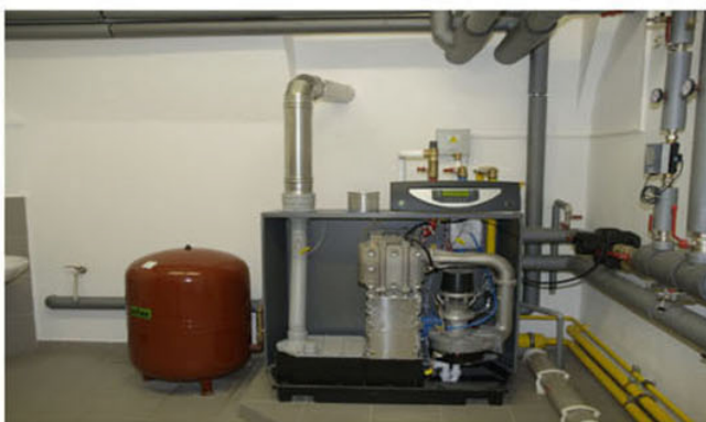
Kondenzační kotelna Vladislavova 100kW
